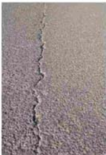
Risse im Asphalt
